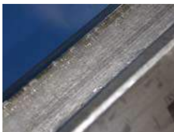
Kaltaufschweißung durch Abrieb
